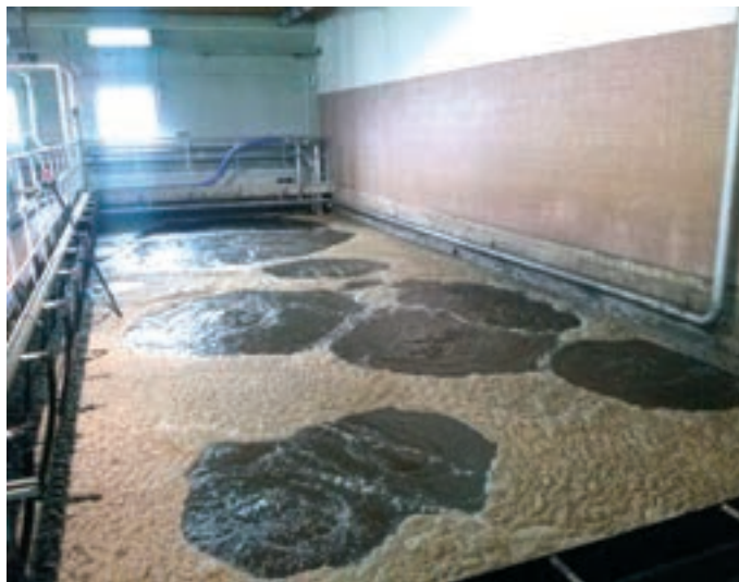
Obr. 5: Nitrifikační nádrž po intenzifikaci
