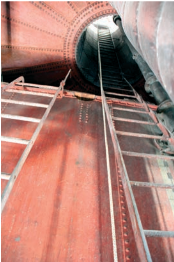
Měděný vodojem ve Vodárenské věži je osazený ve výšce 32 metrů
