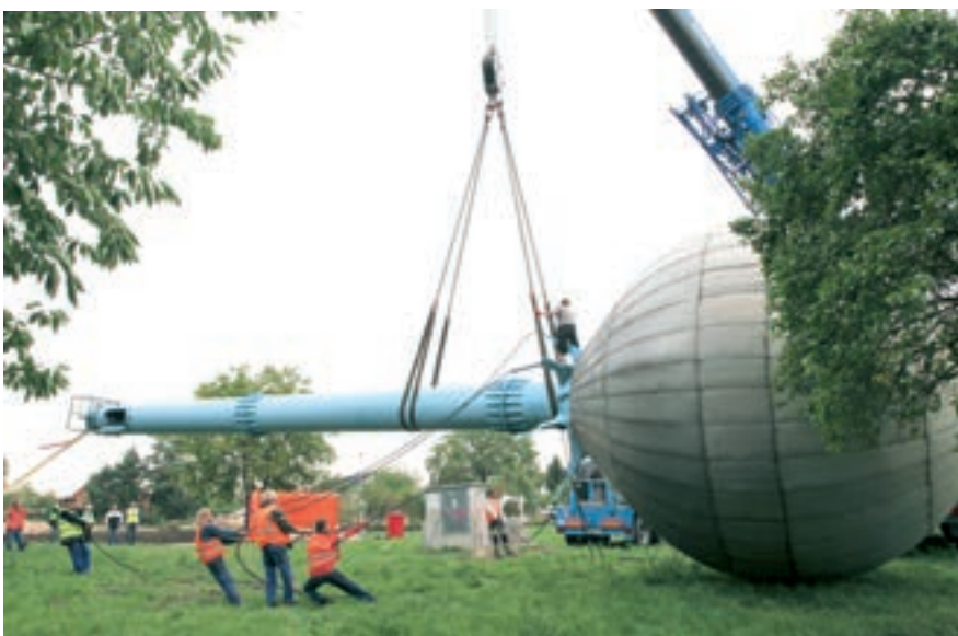
Pokládání vodojemu typu Hydroglobus o objemu 100 m 3 v obci Zdětín u Benátek nad Jizerou
