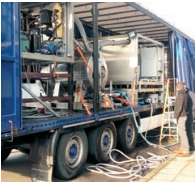
Obr. 2: Mobilní mrazicí jednotka připojená na vodu a elektřinu
