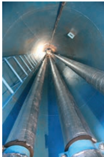
Nový trubní systém vodojemu
