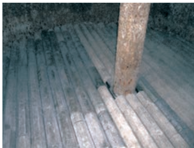
Obr. 1: Filtrační materiál je uložen na prefabrikátech tvaru M se štěrbínami
