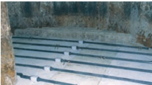
Obr. 2: Rozvody pracího vzduchu ve starých filtrech
