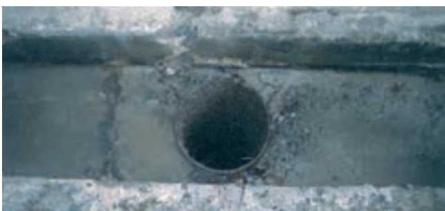
Obr. 4: Filtrát se shromažďuje pod štěrbinovými betonovými deskami ve dvou žlabech a odvádí se z filtrů trubním vedením
