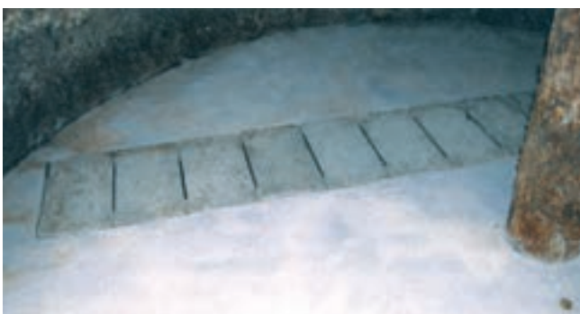
Obr. 3: Rozvody pracího vzduchu jsou uloženy na štěrbinových betonových deskách v podélném směru pod prefabrikáty tvaru M
