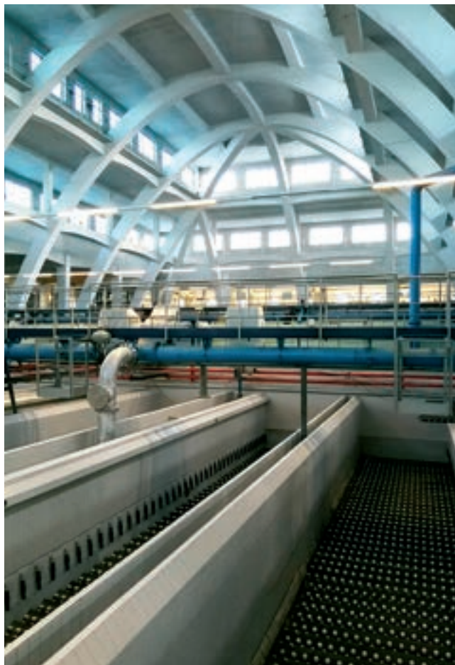
Interiér úpravný vody v Podolí
