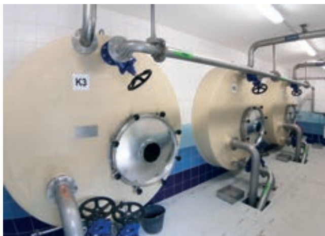
Vystrojení vodojemu Pod hradem
