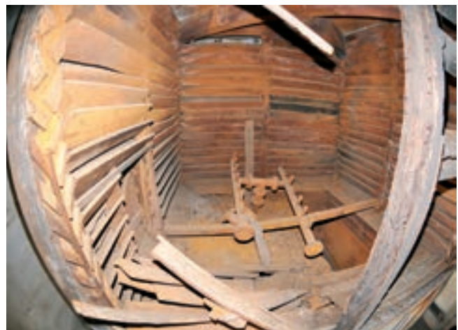
Pozůstatky technologie rozprašování vody v uherskohradištském vodojemu. Zdroj: Archiv projektu, 2018
