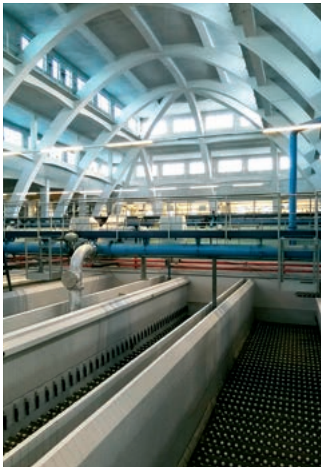
Interiér úpravny vody v Podoli
