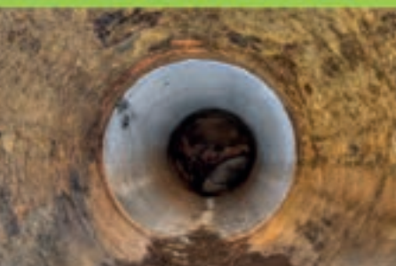
Nevyčištěné potrubí před instalací vystýlky KAWO
