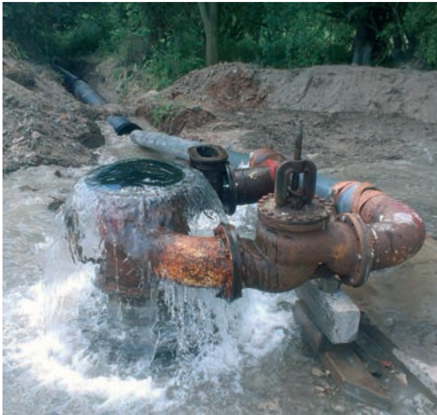
Havarované zhlaví na přetokovém vrtu před rekonstrukcí
