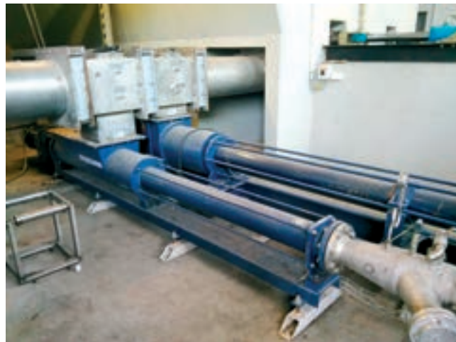
Obr. 2: Čerpání odvodněného kalu na sušárnu ČOV Štětín
