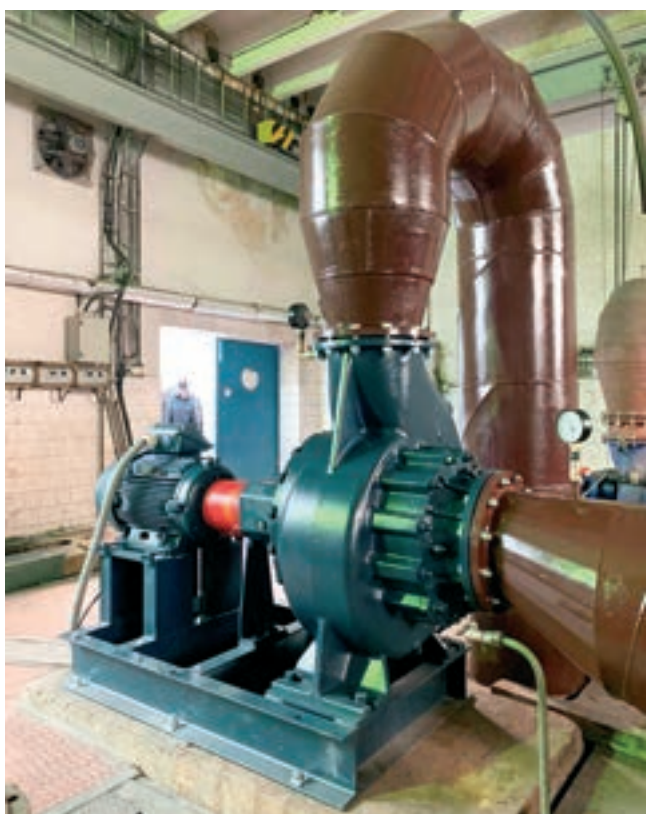
Osadené čerpadlo SPIRAM 300 A-D v ČOV Horný Hričov
