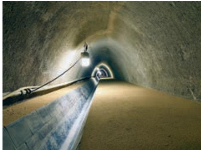
Obr. 8: Výsledná podoba sběrače – definitivní ostění štoly ze stříkaného betonu, dno provedeno jako lité s čedičovou kynetou
