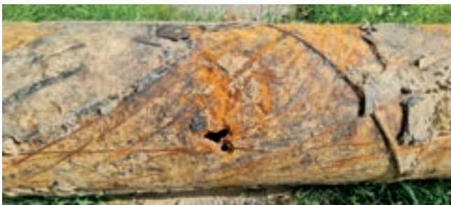
Porušené ocelové potrubí v místě křížení s elektrickou sítí
