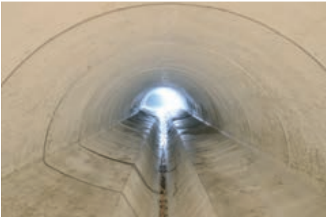
Obr. 5: Stoka z polymerbetonových dílců pod ulicí Milady Horákové
