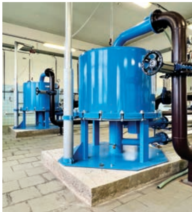
Obr. 3: Nové tepelné výměníky
