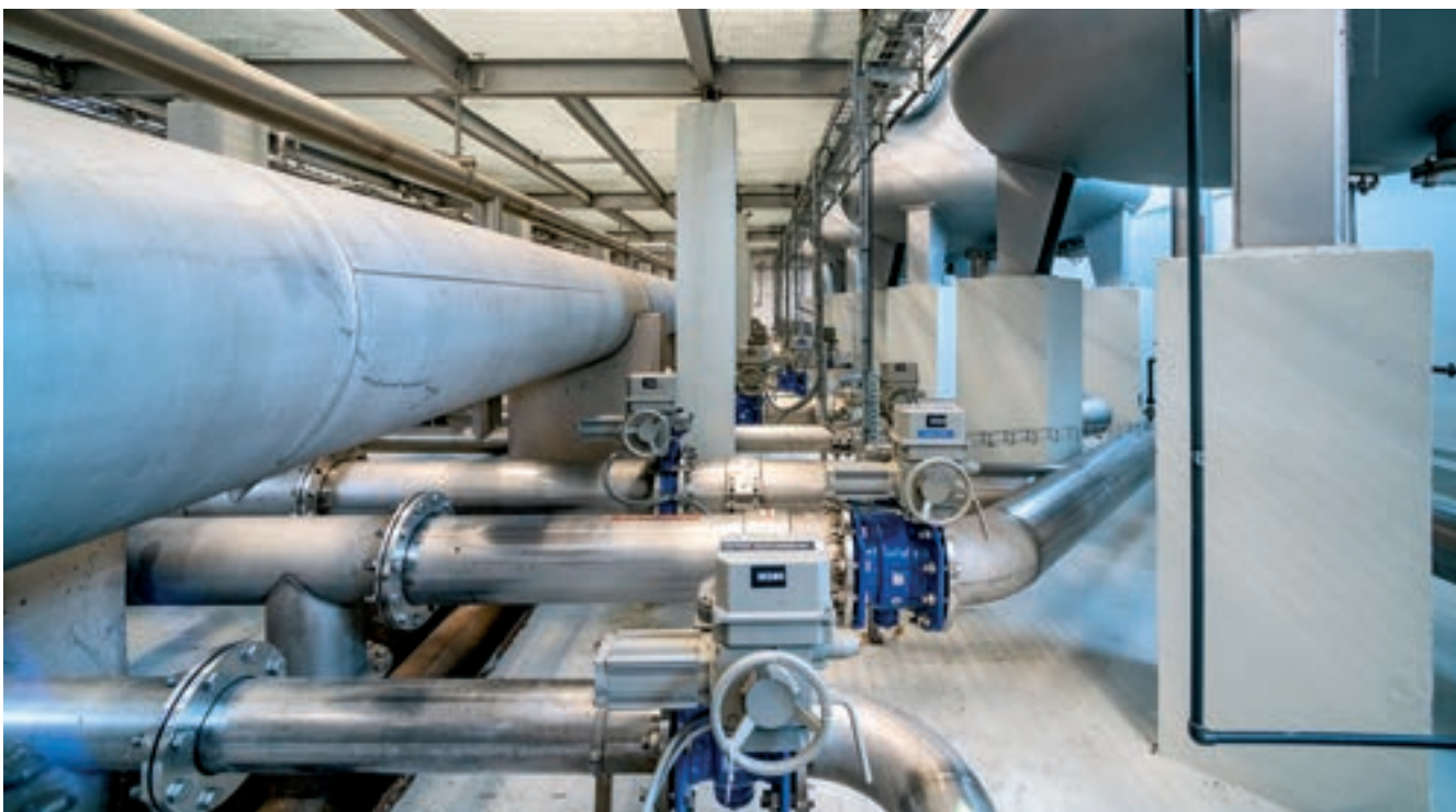
Úpravna vody Hradec Králové, trubní rozvody
