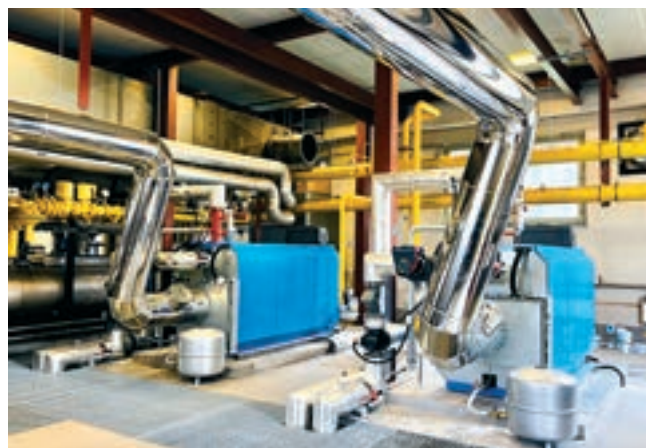
Obr. 4: Nové kotle v energobloku
