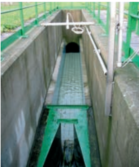
Obr. 1: Protiproudění pohled na přítokové koryto před měrným žlabem s možností nalezení vhodného měrného profilu
