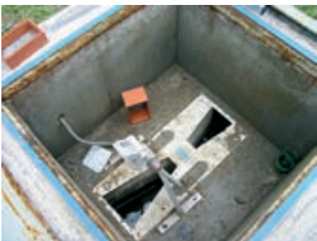
Obr. 2: Nevhodná instalace měrného žlabu bez přístupu k přítokovému korytu
