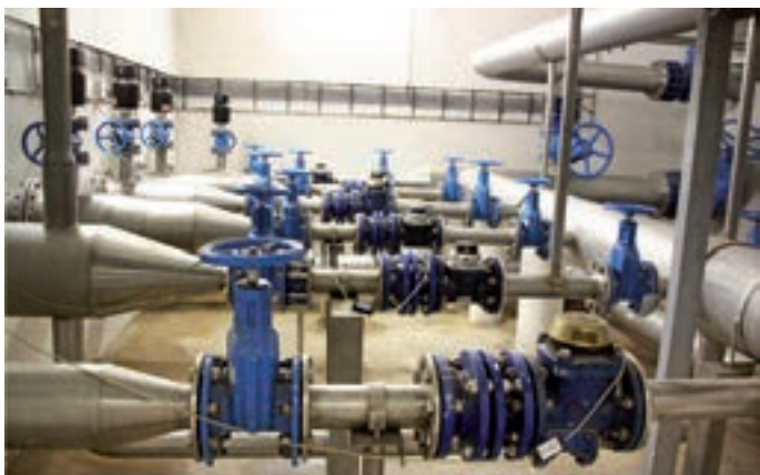
Armaturní komora vodojemu Polkovice
